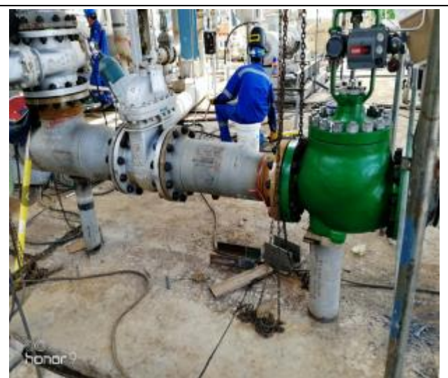
P302 出口到 C301 控制阀组线安装未完成, 管线底部支撑未固定焊死采样器未装 陈金龙
