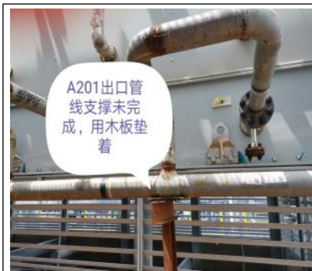
气分 A201 出口管线支撑未完成用木板垫着 方云英
