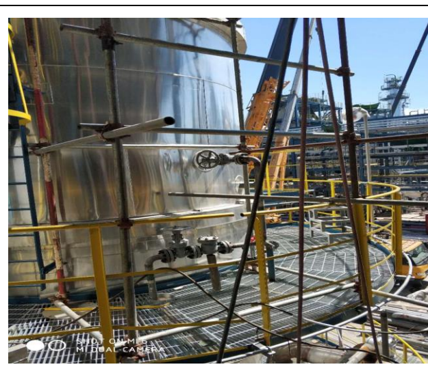
C203 底吹扫蒸汽线缺盲板 苟虎
