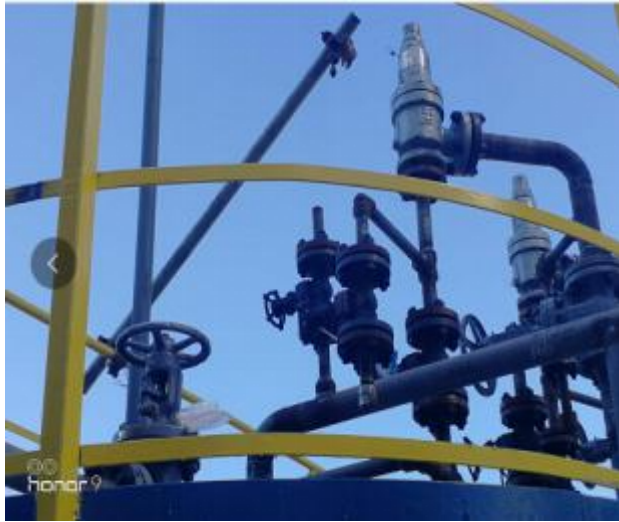
气分 R202A/B 顶部出口现场压力表未安装 PG20701 和 PG20703 陈金龙
