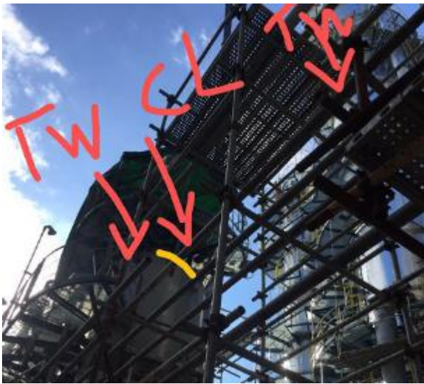
P207 出口管线连接至管廊 TW 总管线(流程错误)。 刘升升
