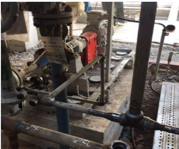
P207AB 泵体排放线连接除盐水线（流程错误）。刘升升
