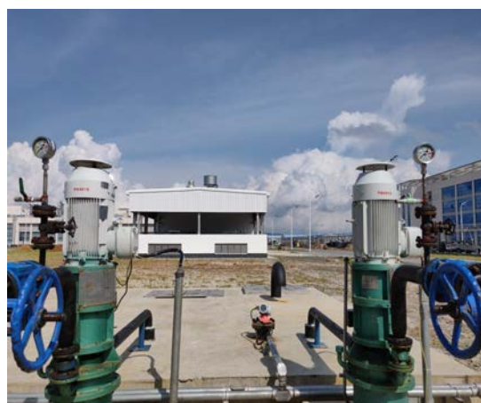
污水提升泵喷位号
